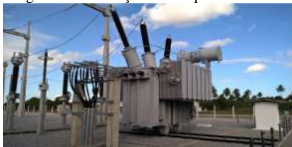
Figura 3: Subestação de Parque Eólico
